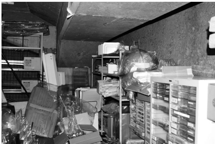
文具店倉庫：右側壁にびっしり青石綿吹き付け部分剥離した跡が目立つ
